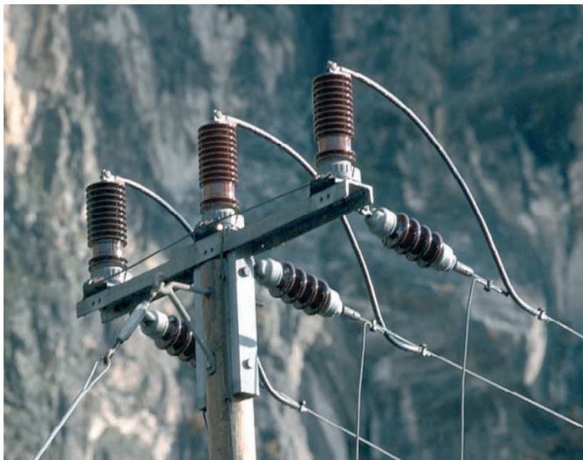
Abb. 6: Nachdem an diesem Endmast im Wallis ein Uhu verunglückt war, wurden die drei Ableiter isoliert. (Bild: R. Arlettaz)
