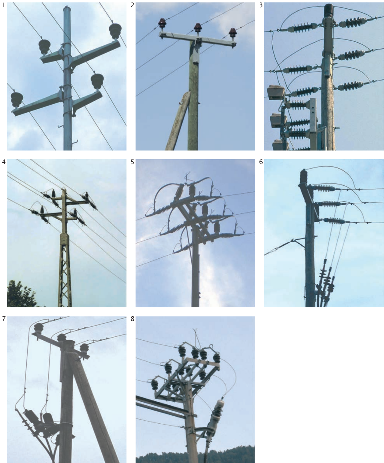
Abb. 4: Die meisten Unfälle geschehen bei Masten mit Stützisolatoren und Leitern oberhalb der Traverse (1-8), gefährlich konstruierten Mastschaltern (5, 8) und bei Endmasten (mit oder ohne Mastschalter 6-8). (Bilder: A. Aebischer und SBB)
