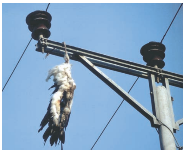
Abb. 2: An einem Mast mit Stützisolatoren durch Stromschlag umgekommener Weissstorch. Ein zweiter Weissstorch lag tot am Boden. (Bild: G. Fiedler)
