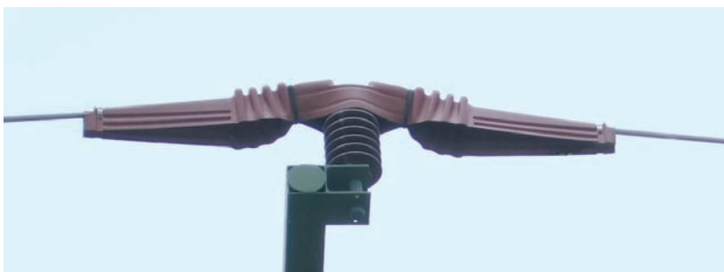
Abb. 7: Stützisolatoren mit Abdeckhauben. Isolierendes Abdeckmaterial soll die Leiter beidseits von Isolatoren auf einer Länge von mindestens 60 cm abdecken. (Bild: A. Aebischer)
