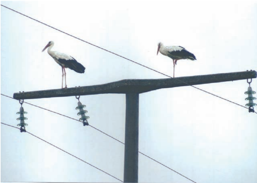
Abb. 10: Weissstörche auf einem vogelfreundlichen Mast mit Hängeisolatoren. Der Abstand zwischen der oberen Kante der Traverse und den Leitern sollte mindestens 60 cm betragen. (Bild: G. Fiedler)
