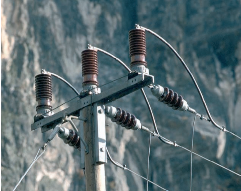
Fig. 6: Après l'accident survenu à un hibou grand-duc sur ce pylône d'arrêt, les trois parafoudres ont été isolés. (Photo: R. Arlettaz)
