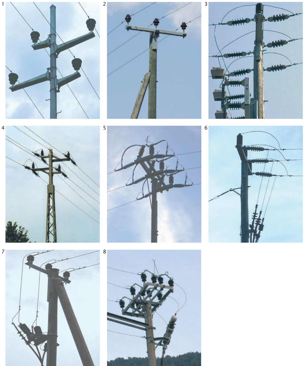
Fig. 4: La plupart des accidents surviennent sur des mâts avec isolateurs-supports et des conducteurs passant au-dessus des consoles (1-8), sur des interrupteurs dangereux (5, 8) et sur des mâts d'arrêt (avec ou sans interrupteurs 6-8). (Photos: A. Aebischer et CFF)
