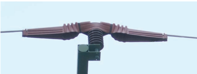
Fig. 7: Isolateurs dressés avec calottes de recouvrement. Le matériel de couverture isolant doit couvrir les conducteurs des deux côtés des isolateurs sur une longueur d'au moins 60 cm. (Photo: A. Aebischer)
